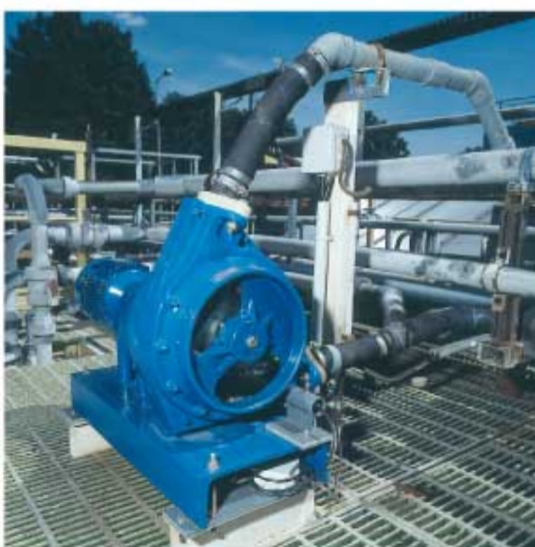
Pompa Z per la neutralizzazione degli effluenti
